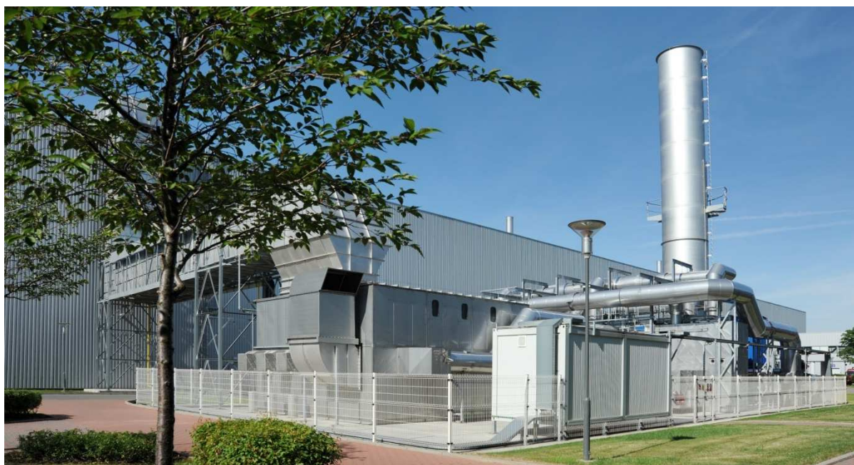
Obr.6 Zařízení pro regenerativní termickou oxidaci (RTO)
