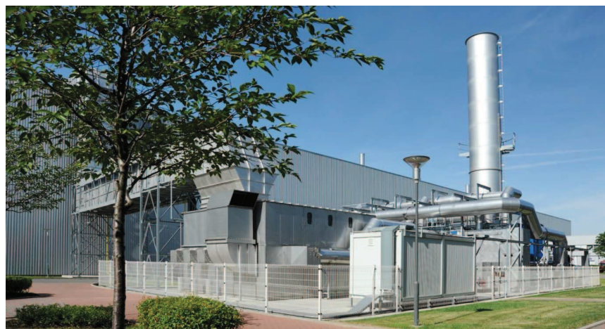
Obr.6 Zařízení pro regenerativní termickou oxidaci (RTO)
