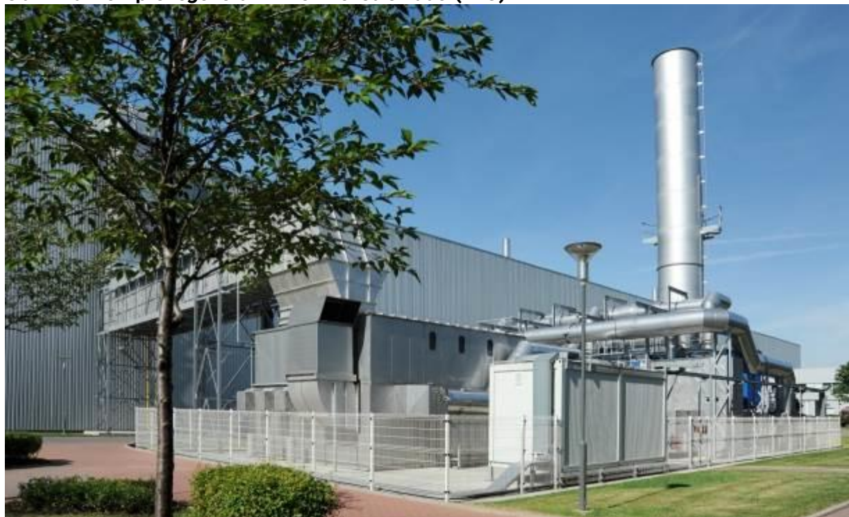
Obr.7 Zařízení pro regenerativní termickou oxidaci (RTO)
