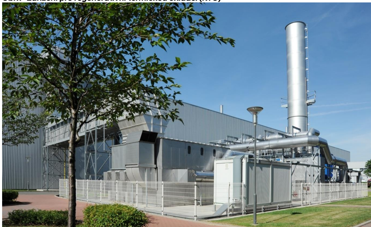
Obr.7 Zařízení pro regenerativní termickou oxidaci (RTO)
