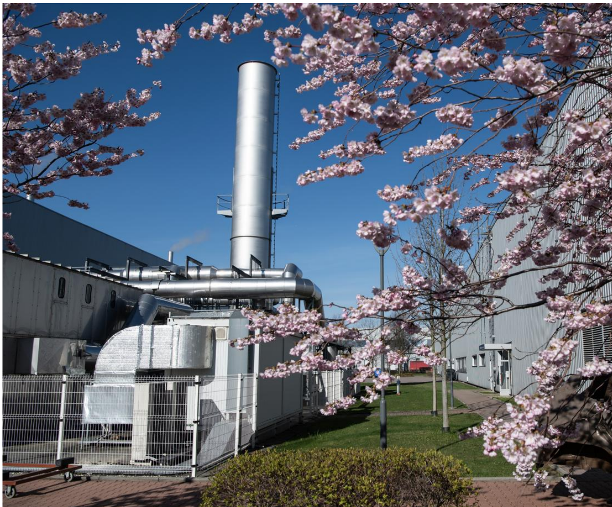
Obr.18 Zařízení pro regenerativní termickou oxidaci (RTO)
