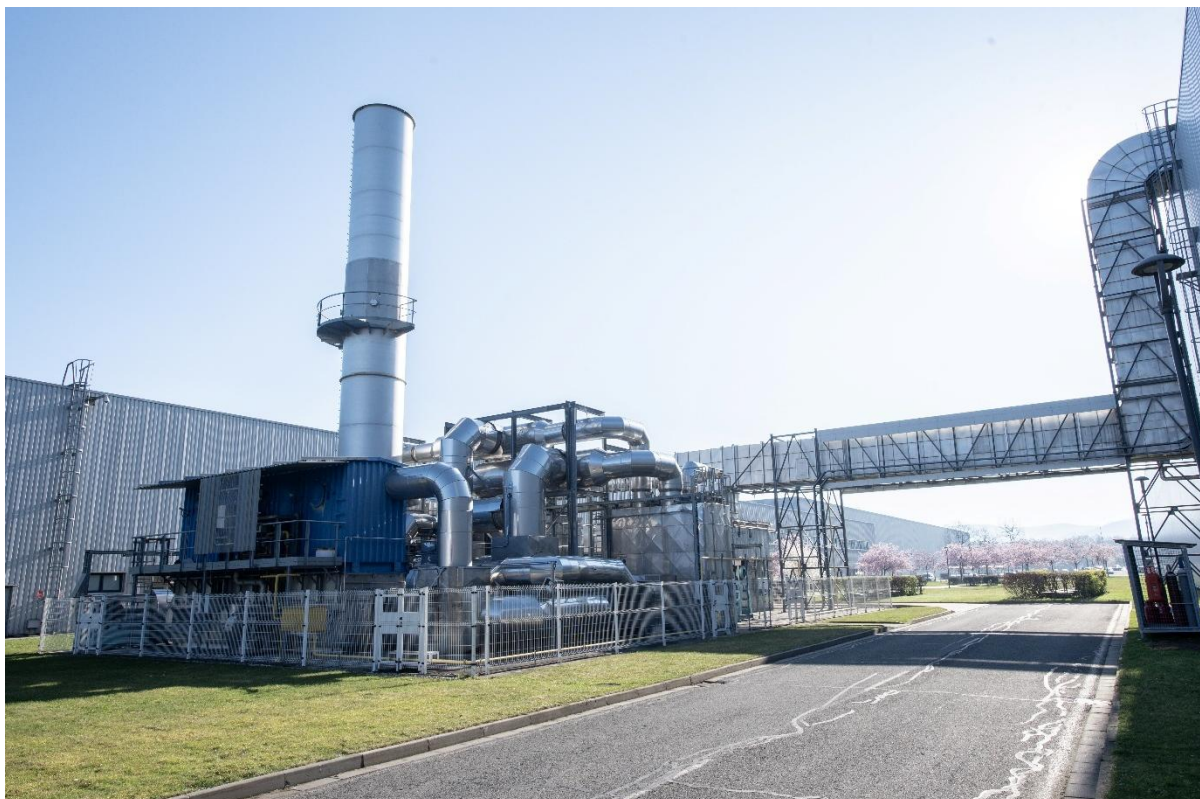
Obr.13 Zařízení pro regenerativní termickou oxidaci (RTO)
